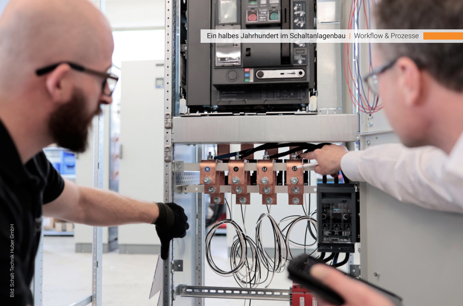
Bild 1 | Erfolgreich am Markt seit über 50 Jahren – die Firma Schalt-Technik Huber durchlief einige Transformationen.
